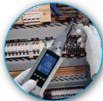
Contrôle sur tableau avec cordon M-952271.
